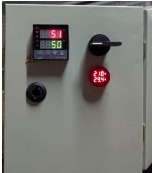
Figura 14. Sistema de control de temperatura mediante controlador XMTG-808.
